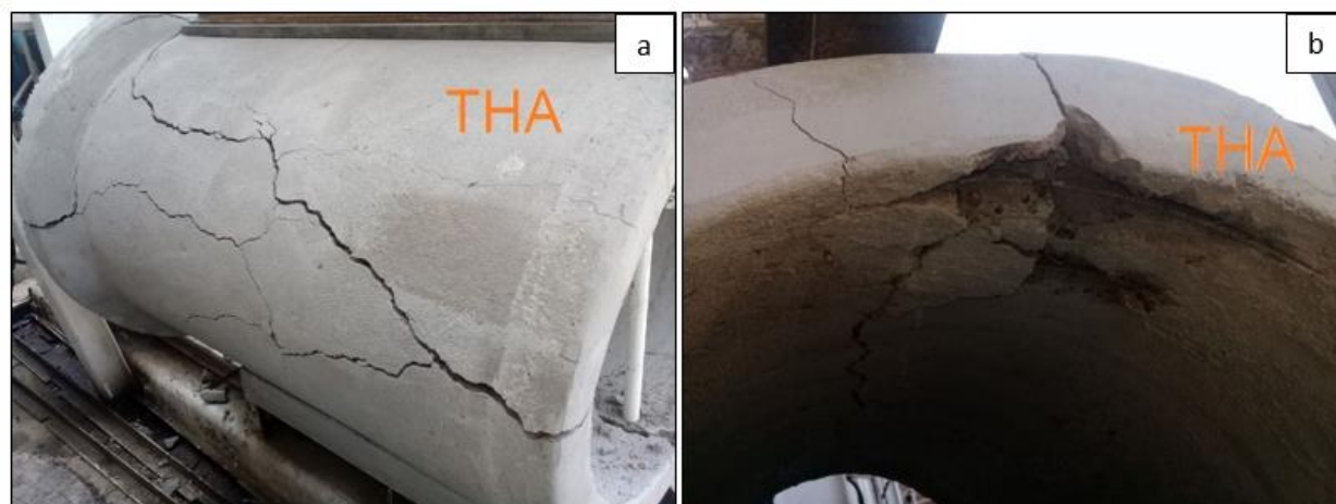
Figura 5. a) Patrón de fisuración longitudinal. b) Desprendimiento de hormigón en la clave de un THA.
